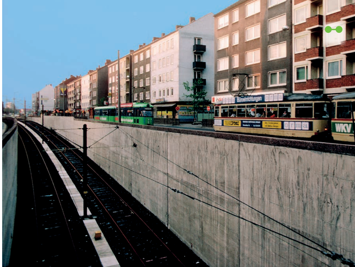
Noch oberirdisch: Während der Baumaßnahmen für die neue Tunnelstrecke wurden die Straßenbahnen neben der Baustelle entlanggeführt – hier neben der Tunnelrampe in der Vahrenwalder Straße.
